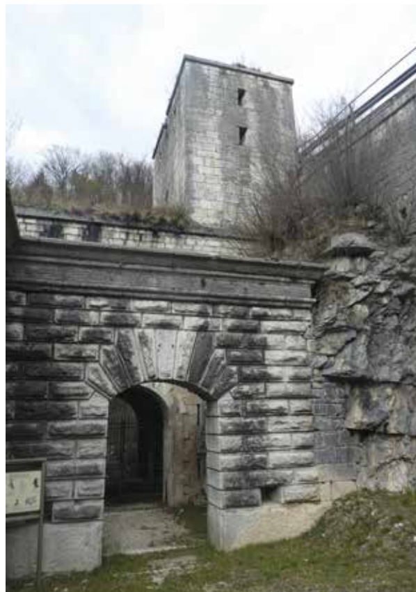
Fortificazioni della Tagliata di Primolano costruite con blocchi lavorati di Titoniano Bianco estratti nella vicina cava.
